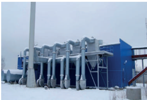
Рис.7. Общий вид котельной с котлами КВП 1.74 ВТКС п. Горская, Лен. обл.
