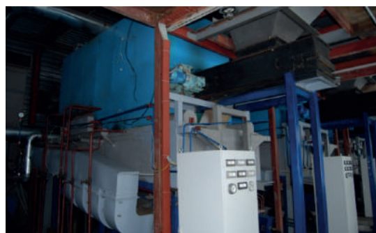
Рис.6. Котлоагрегат с топкой высокотемпературного кипящего слоя КВП 1.74 ВТКС
